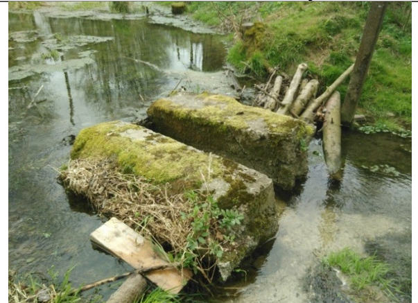
Ancien vannage, infranchissable
