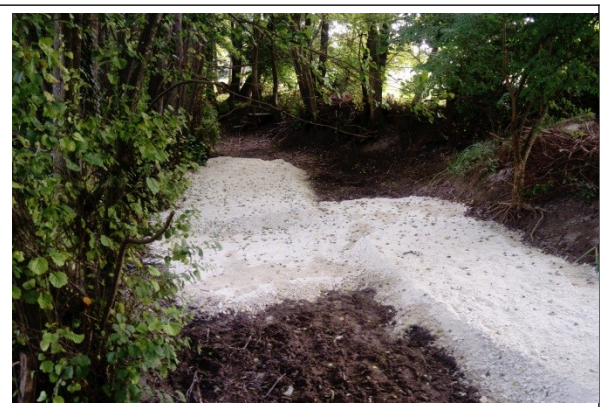
Mise en place de matériaux dans le lit mineur du cours d'eau afin de réduire le gabarit du lit
