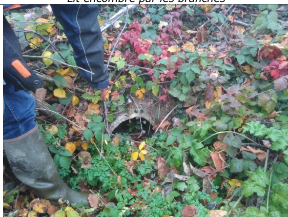
Connexion amont/aval rendu difficile par une buse au faible diamètre
