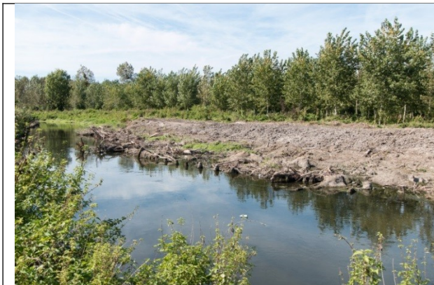
Rétrécissement du gabarit du lit du cours d'eau par mise en place d'un boudin rempli de terre.
