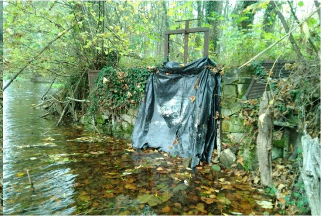
Vanne avec bâche plastique en aval
